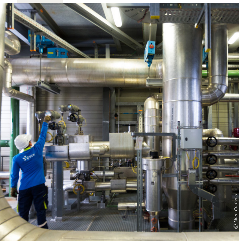
EDF - Centrale de Bouchain
